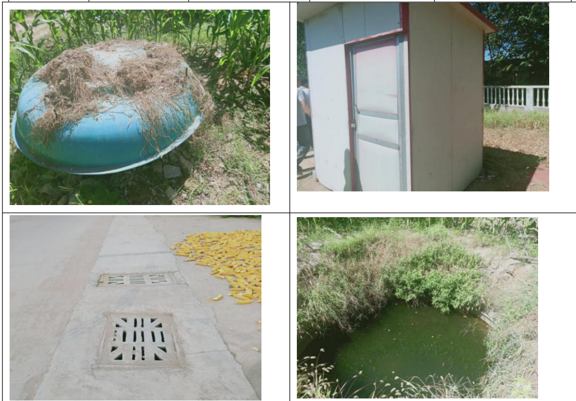
图 4.2.1-1 污水治理设施现状图
