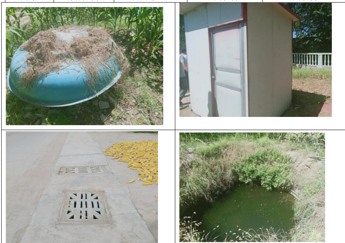
图 4.2.1-1 污水治理设施现状图
